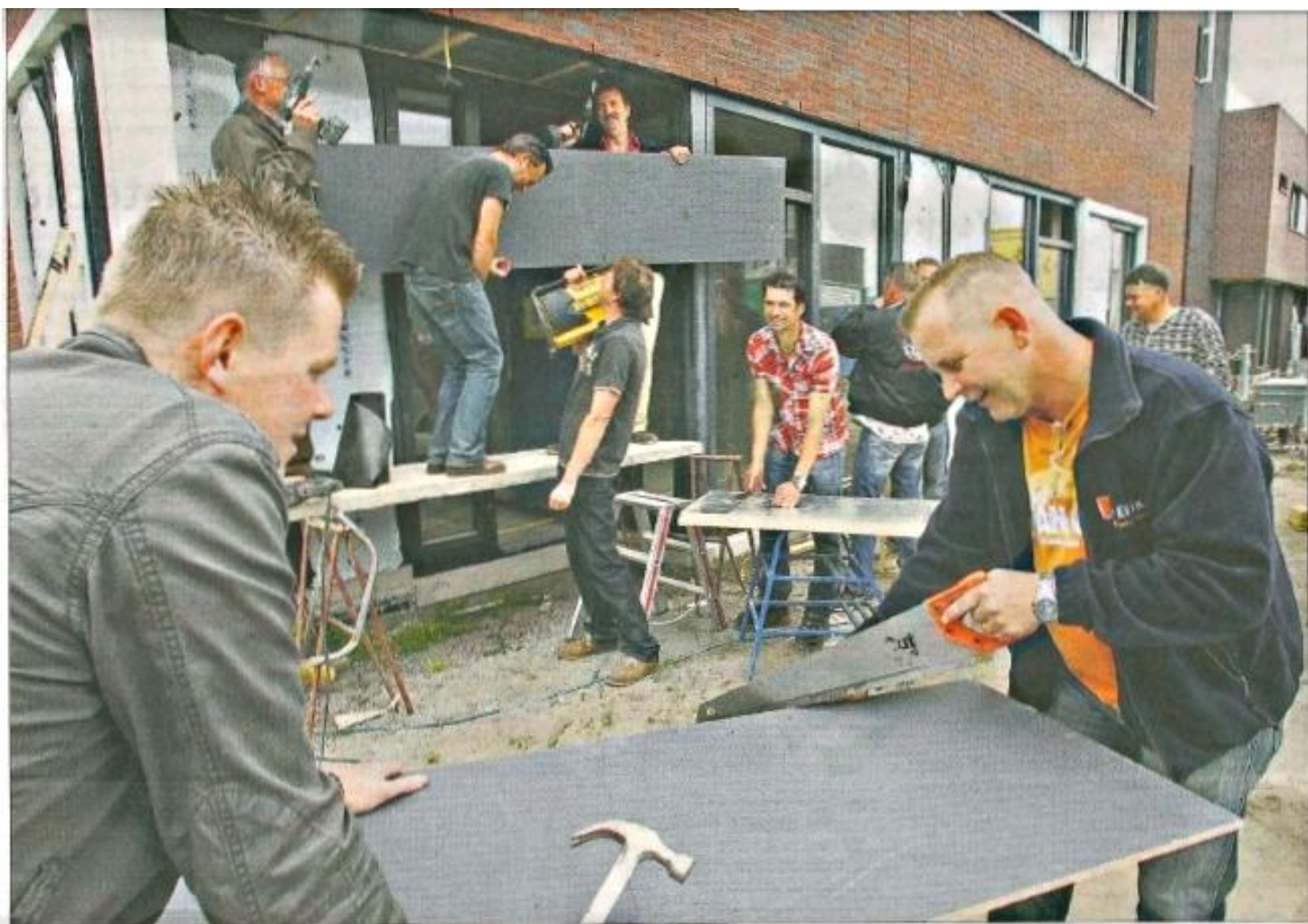
De mannen werden in acht maanden klaargestoomd tot timmermannen die als rechterhand van de uitvoerder kunnen fungeren.
